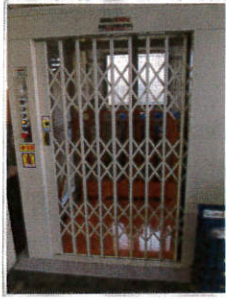
荷物エレベーター (作業効率向上)
